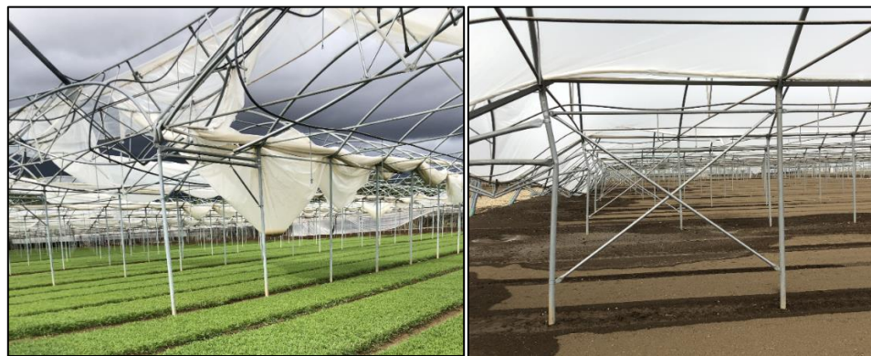
Fig. 5. Sinistri nell’Agro-Pontino e Piana del Sele. Controventi evitano effetto domino e danno totale
